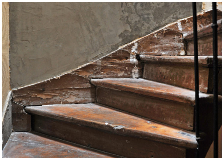
En cas de dégradations trop importantes, l'autorisation de louer pourra être rejetée ou soumise à une obligation de travaux.
