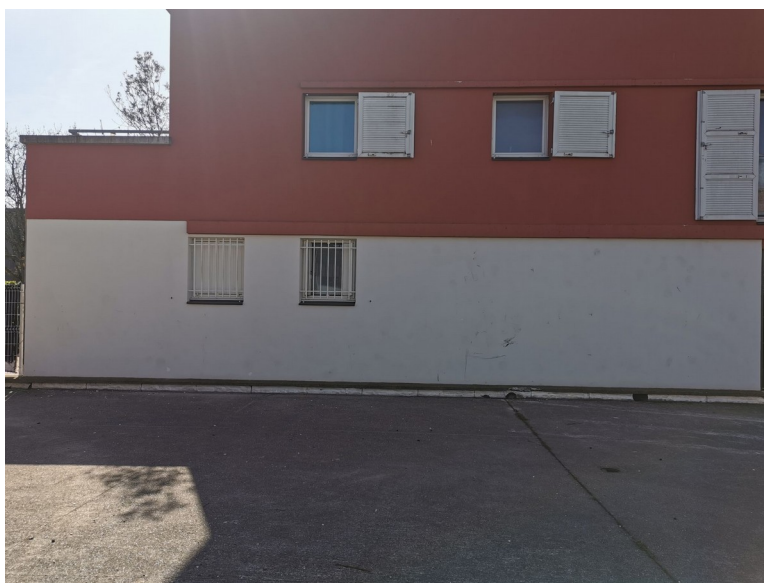
MUR 1 (droite) H ± 2,50 m – L 12,20 m soit ± 30,50 m 2
