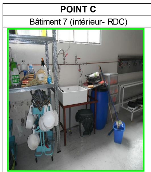
Figure 5 : Point de prélèvement du réseau rénovée d'eau du robinet
