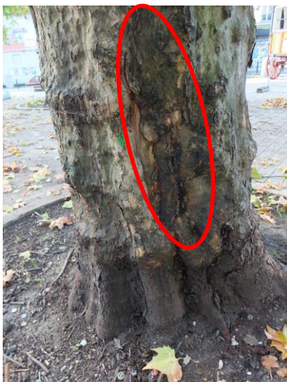
Plaie sur tronc légèrement dégradée
